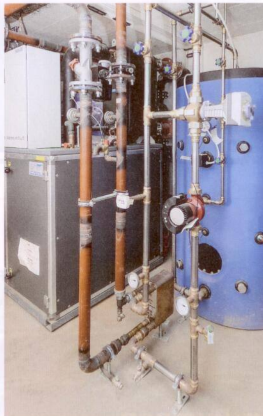
Speicher mit Warmwasser-Erwärmung via Wärmepumpe.
