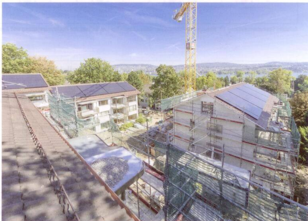
Die energetische Komplettsanierung der sechs Mehrfamilienhäuser an der Seestrasse in Zürich-Wollishofen. (Fotos: Roland Spring, Oberburg)
