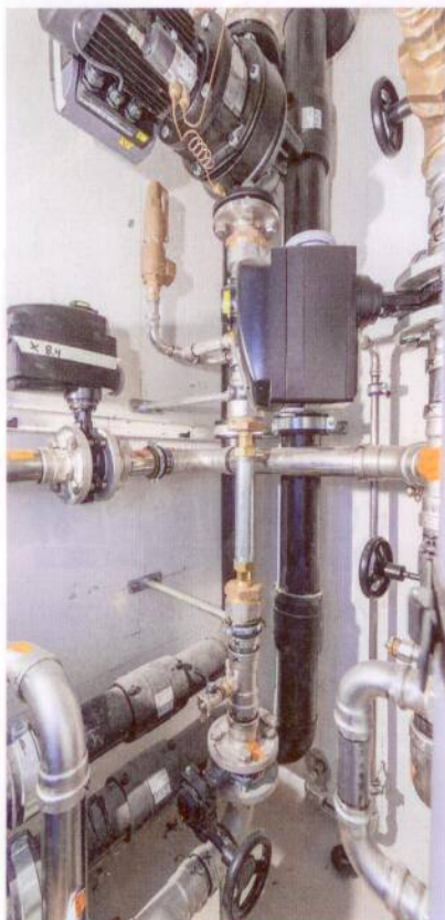
Anschluss an Erdsondenleitung.
