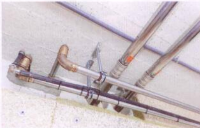
Warmwasser- und Solarleitung.
