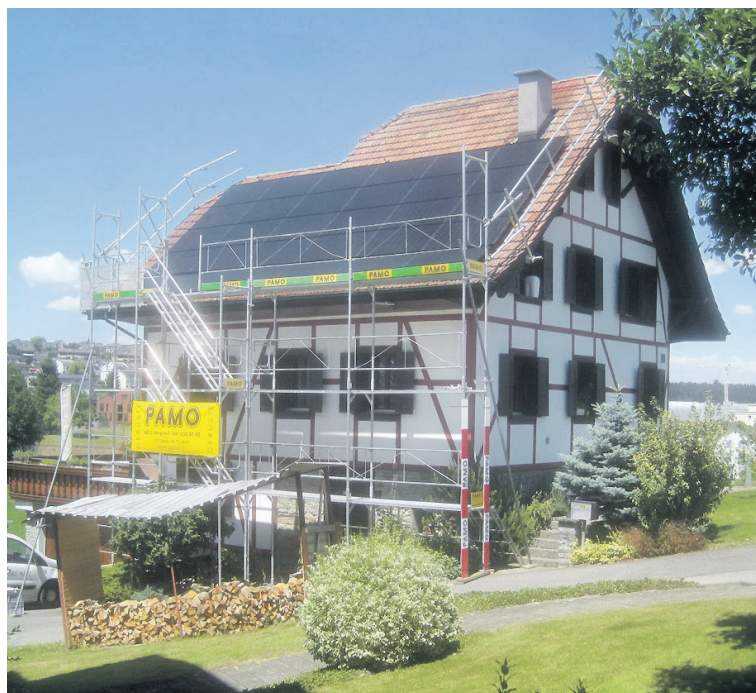
Einfamilienhaus mit einer aufgebauten Photovoltaik-Anlage.
