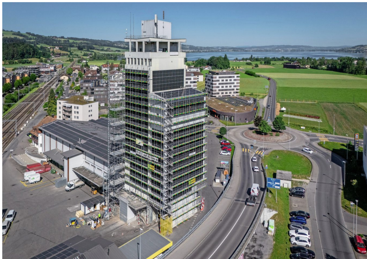
Der Futtermühlenturm der Landi in Sempach Station dient bald als grosses Solarkraftwerk.
