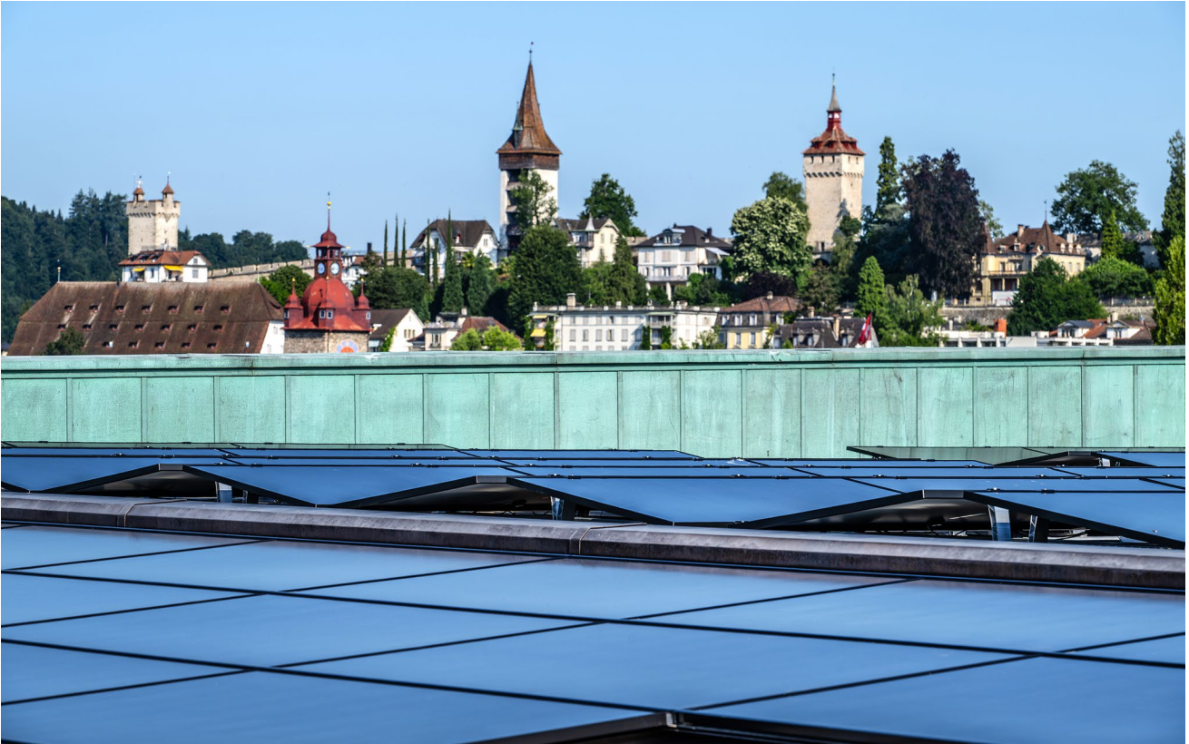
Bild: Photovoltaik Anlage von BE Netz AG auf dem Dach vom KKL Luzern (Bild: BE Netz AG)
