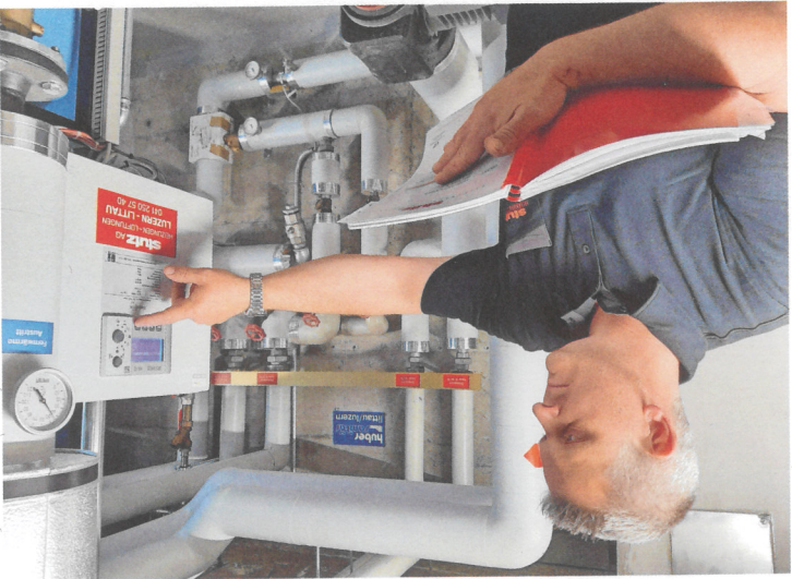
Denis Gajska, Projektleiter und Co-Geschäftsinhaber der Littauer Stutz AG, Heizungen und Lüftungen, vor einer Fernwärmanlage im Littauer Mathof.
