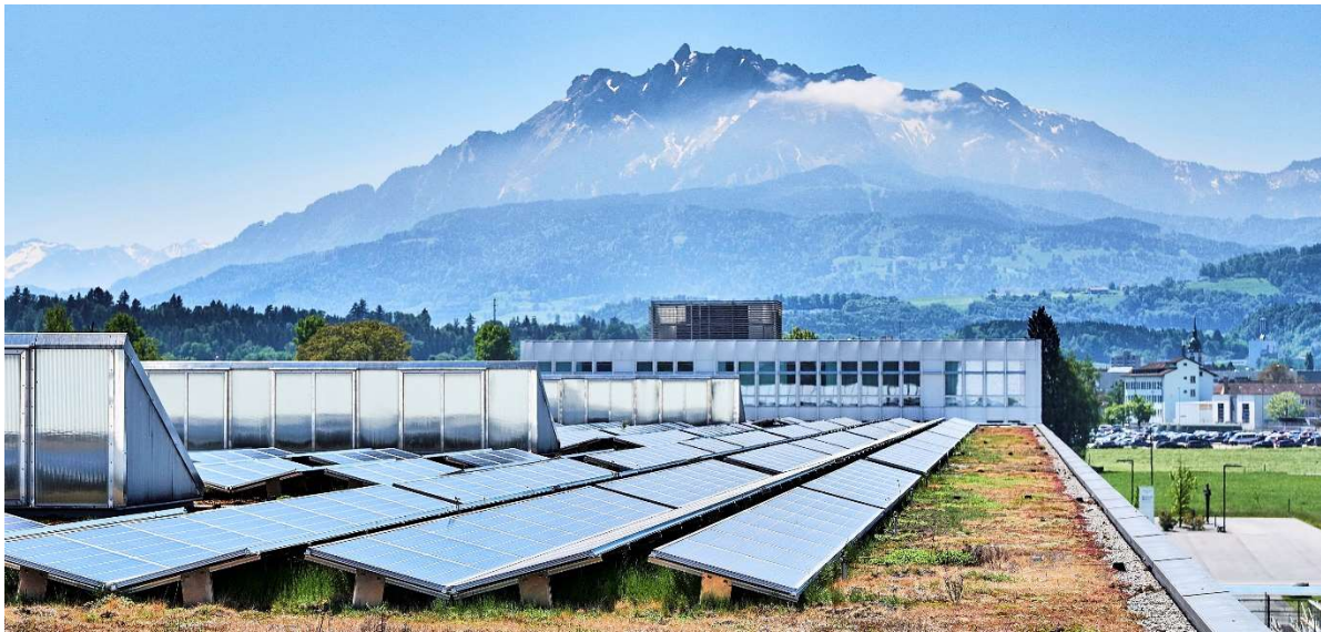
Abb. 1: Photovoltaik-Anlage auf der Werkhalle, Emmen (Bildquelle 4B, Fotograf Dennis Beyer)
