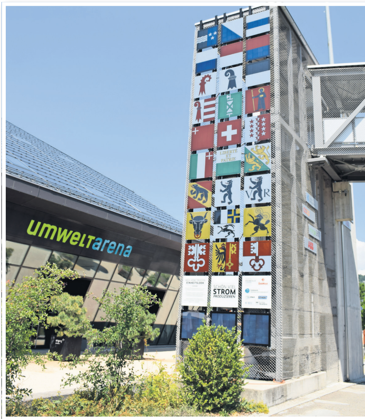
Für die Umwelt Arena Schweiz plante und installierte BE Netz die PV-Anlage «Swissness» mit bedruckten Modulen.
