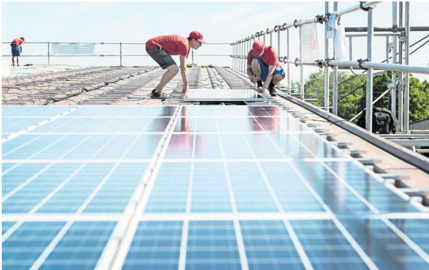
Auf immer mehr Luzerner Hausdächern sind Fotovoltaikanlagen zu sehen.
