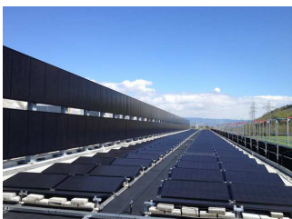
Die 229.6 kW-Aufdachanlage. Bild: BE Netz
